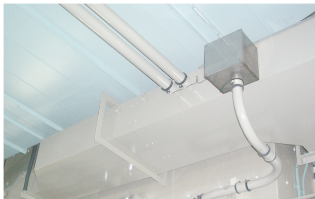
焼付塗装仕上げ 配線ダクト
