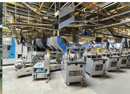
搬送システム設備
