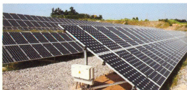
太陽パネル接続BOX
