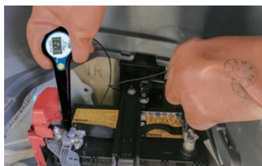
補機バッテリーの電圧測定
