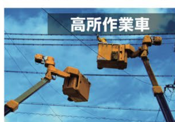
架空配電線/送電線
