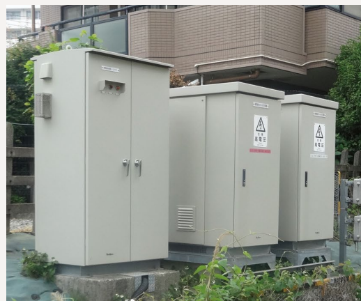
融雪器制御盤、コンパクト変圧器盤
