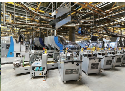
搬送システム設備
