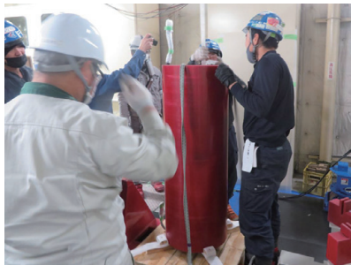
▲パーツとして搬入したモールドコイル。ガラス繊維で強化した頑強なコイルです。
