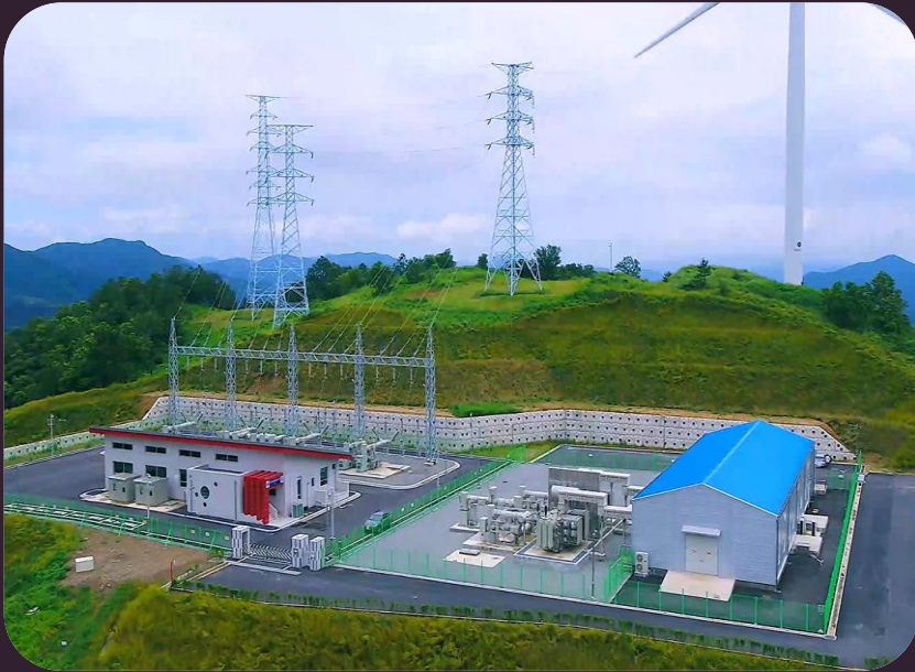
韓国 | 93MW PV, 242MWh ESS ピークシフト | 2020年建設 | EPC/O&M
