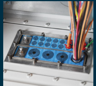
PLC キャビネット
