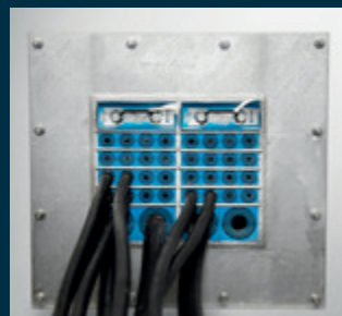
制御・計装ケーブル
