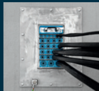
MV / LV 電力ケーブル
