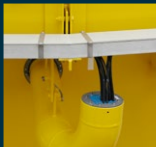
3. デッキ設備ケーブル
