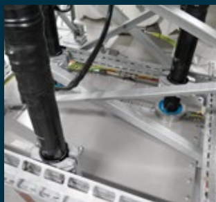
5. 高電圧ケーブル
