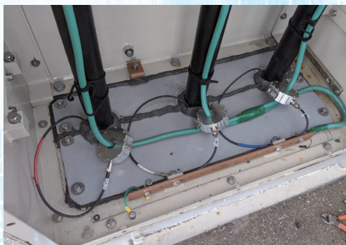
接地線用センサー設置の様子
