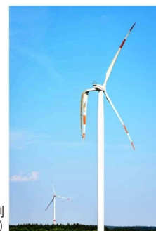
落雷によって破損したブレードの例 (海外の事例)
